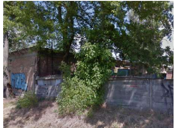
Népsziget úti gáznyomásszabályzó
