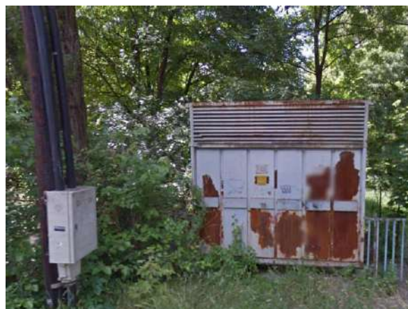
4103-as sz. lemezházaz 10/0,4 kV-os transzformátor
