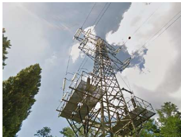
ELMŰ 120 kV-os légvezetékes hálózat kábelfejes oszlopa
